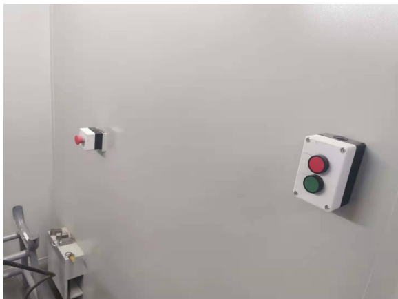
图 4-3 探伤室内紧急停止按钮
