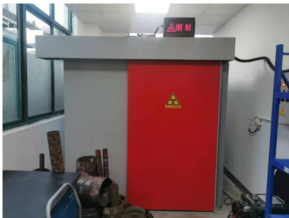
图 4-1 探伤室整体现状、防护门辐射安全警示标志、状态警示
