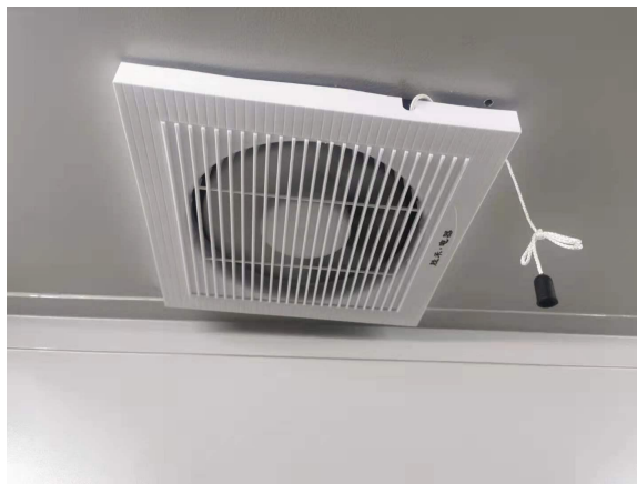
图 4-2 探伤室通风装置
